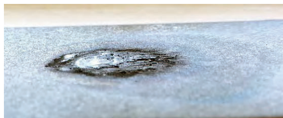
Macchia di saldatura rimossa
